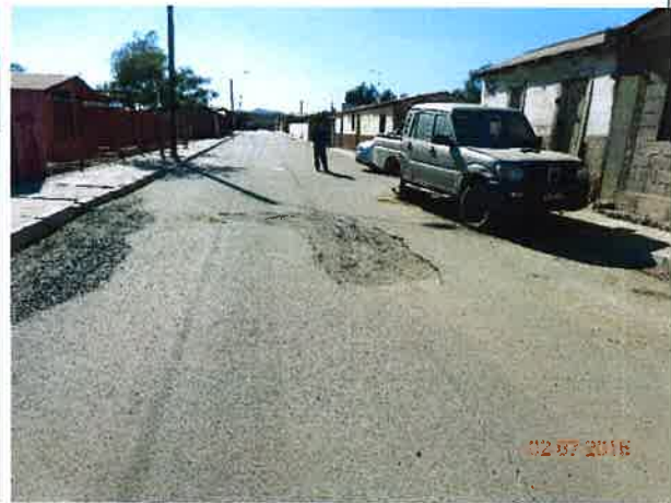
Fotografía N° 2: asentamiento de la calzada y desprendimiento de pavimento en calle Ovalle - Vicuña.
