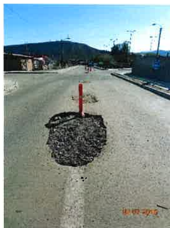
Fotografía N° 5: asentamiento de la calzada en calle Gabriela Mistral.
