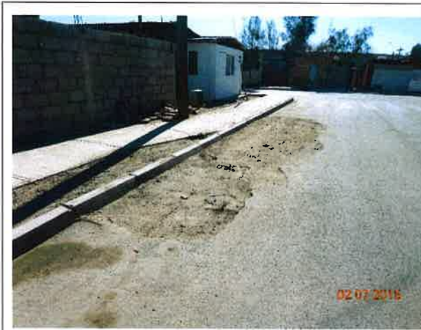
Fotografía N° 1: desprendimiento de pavimento en calle Marigol.
