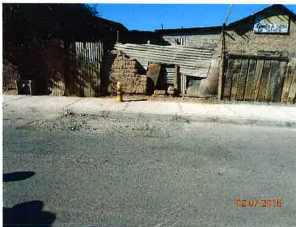
Fotografía N° 3: defecto constructivo de pavimento en calle Nicolás Naranjo.
