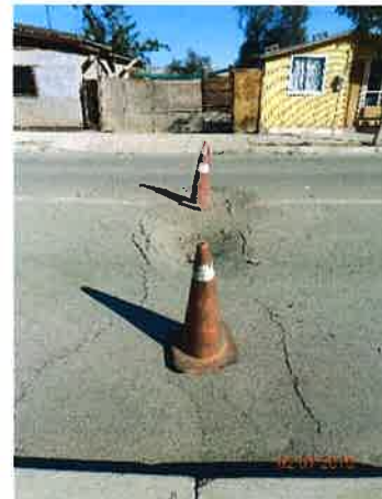
Fotografía N° 4: asentamiento de la calzada en calle Gabriela Mistral.
