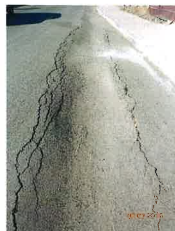
Fotografía N° 6: asentamiento de la calzada en calle La Plata.
